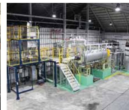
▲リン酸塩製造設備（県の補助金活用）
