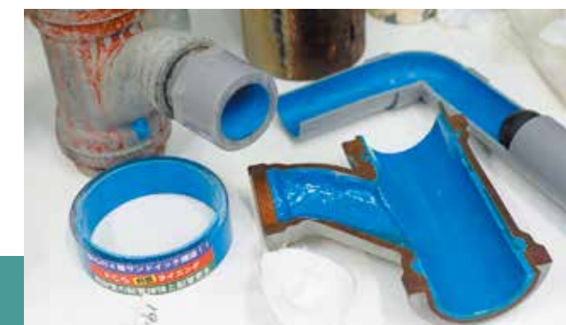
▲FRPライニング工法による、給排水管内の様子。腐食した管であっても特殊な塗料が隅々までいきわたり、更生させることができます
