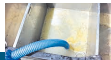
◀グリストラップに 集められたゴミや 油脂は、バキューム 車で吸引する
