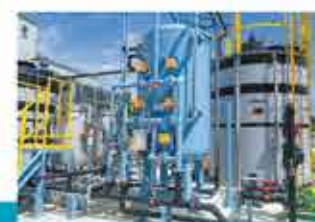
▲井水ろ過装置
