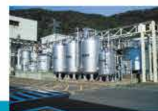
▲排水処理装置
