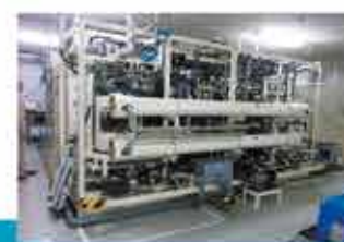
▲超純水製造装置
